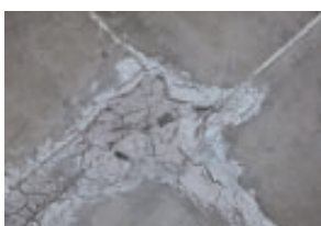
Detailansicht der undichten Folienabdichtung.
